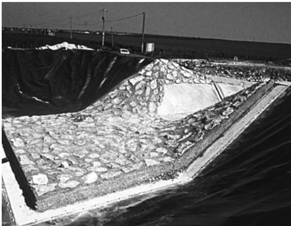
Structure de protection sous arrivée de liquides
